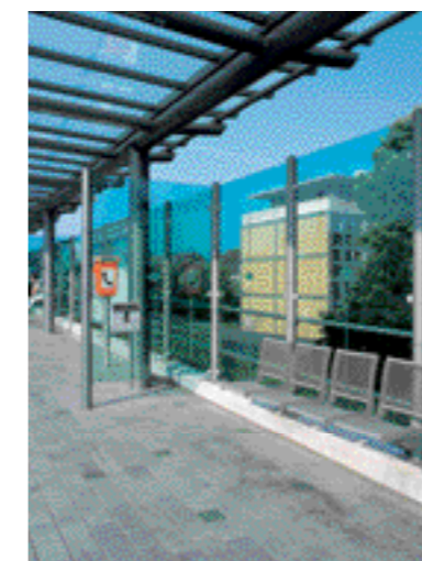
Metro/tram bedrijf Duisburg, Stadtbahn Rhein-Ruhr: Overkapt perron, 2 jaren niet gereinigd.
