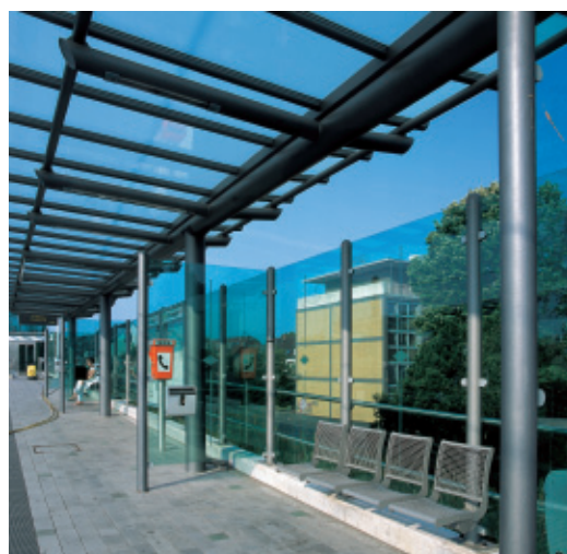
Metro/tram bedrijf Duisburg, Stadtbahn Rhein-Ruhr: Overkapt perron, 2 jaren niet gereinigd.
